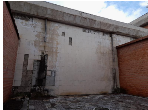
Фиг.12 Югоизточна фасада на зрителната зала, увредената облицовка от мраморни плочи от течовете от водосточните тръби; 2023
