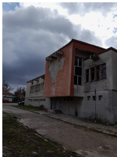
Фиг. 20 Североизточната фасада с изнесеня обем на ритуалната зала и увредената фасадна облицовка от течащата вода от барбаканите, 2023
