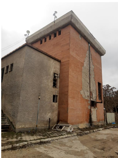
Фиг. 19 Североизточна фасада със сценичната кула с увредената фасадна облицовка от течовете от водосточната тръба, 2023
